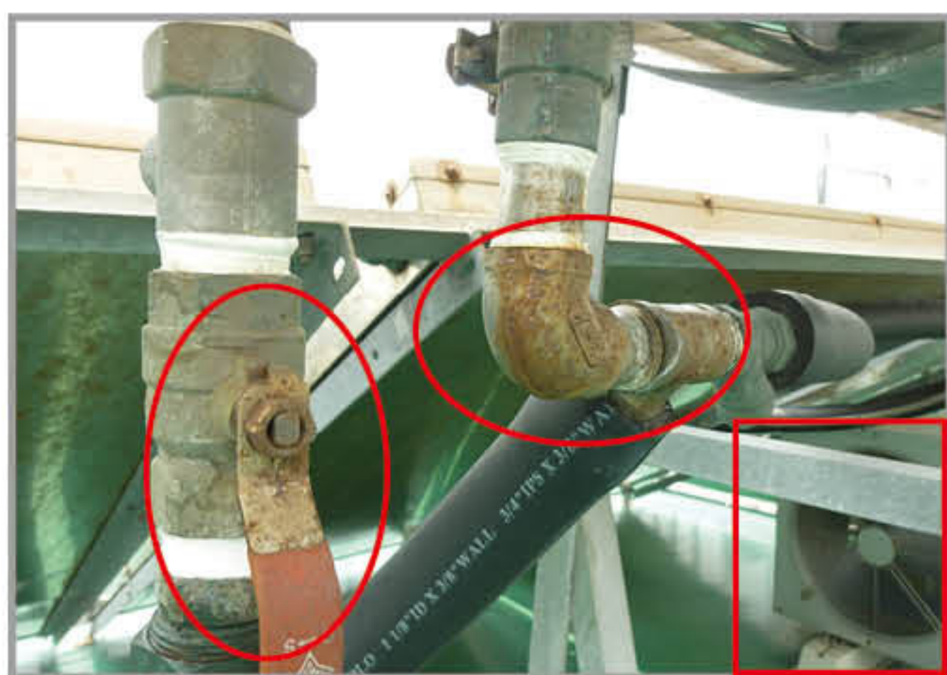
沿海高鹽分地區安裝一般元件水鏽覆蓋情形 鑫威利熱泵高品質、抗鹽害、不鏽蝕
