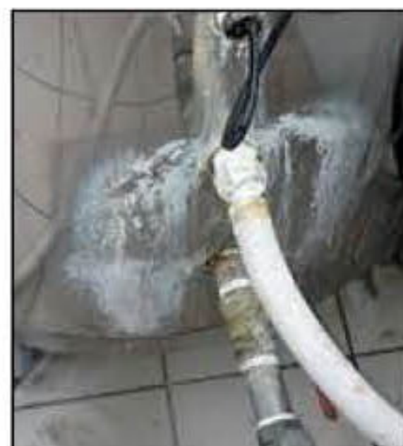
保溫桶施工不當 品質差 = 效能差 = 漏水
