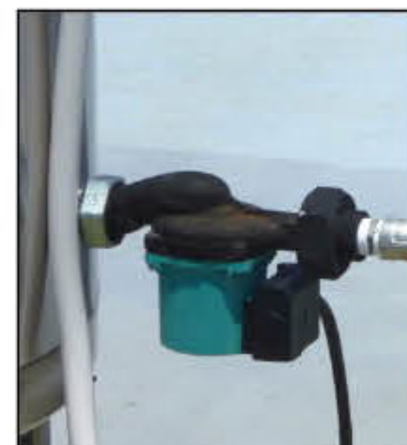
鑄鐵水泵容易鏽蝕 裝置錯誤影響功能
