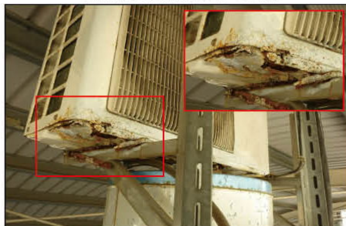
主機外殼材質不良、銹蝕嚴重 = 報廢
